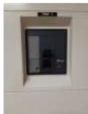
Ubicación protección entrada SAI 1 THM1
